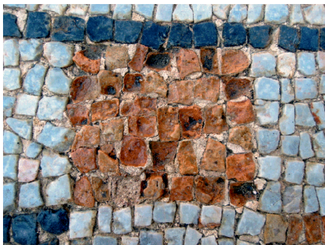
Ψηφίδες διαβρωμένες από την υγρασία. Tesserae corroded by the humidity.
